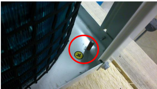
Figure 9 : Connexion de mise à la terre sur la plateforme du groupe
