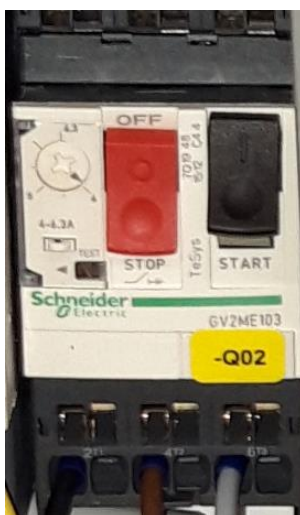
Figure 29 : Disjoncteur avec protection contre les surintensités
